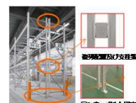
保管棚固定装置
