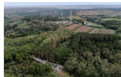
台風15号により倒壊した鉄塔
