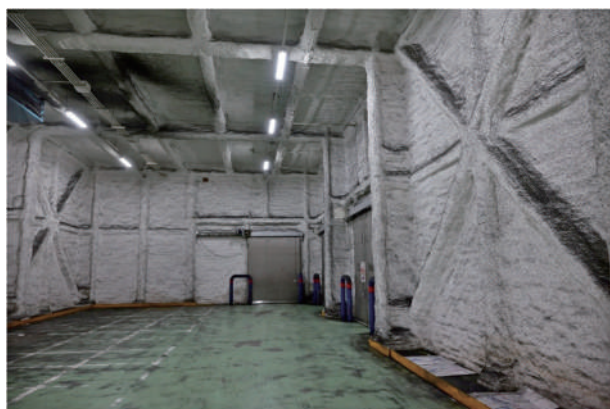
冷蔵保管設備の内部
